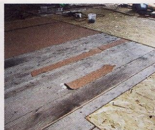
Подготовка чёрного пола для укладки ламината: выравниваем плоскости досок с помощью пробковой подложки и укладываем листы ОСП.
